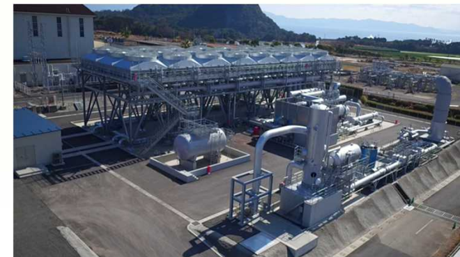
山川バイナリー発電所外観
