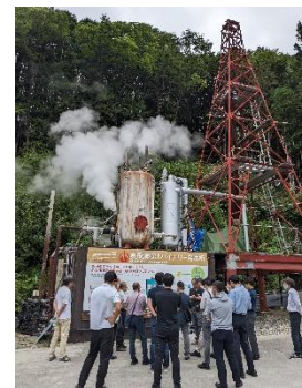
奥飛騨第1バイナリー発電所
