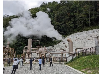
奥飛騨温泉郷 中尾地熱発電所
